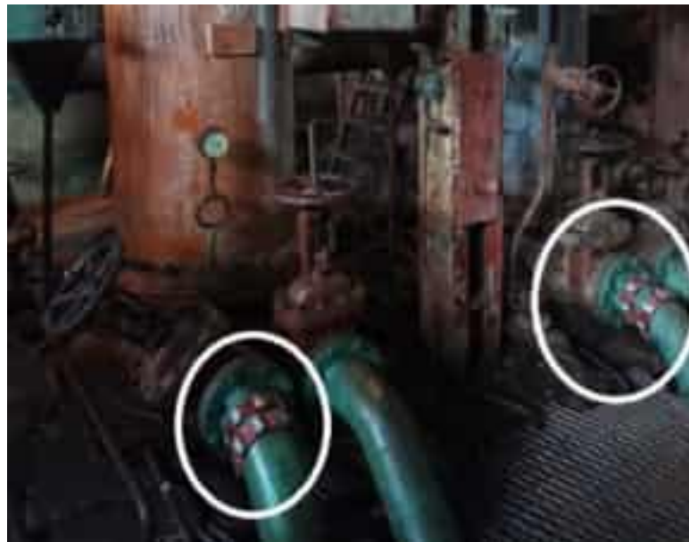
Figura 3. Ubicación de los dispositivos magnéticos a la entrada de agua en los Intercambiadores de aceite
