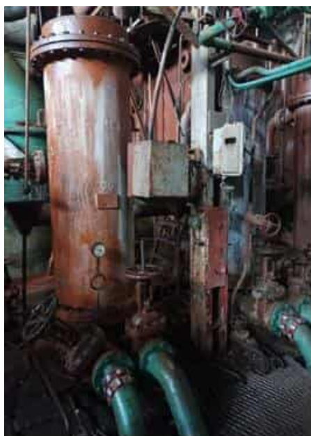
Figura 2. Intercambiador de calor de la CTE Renté
